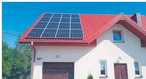
Instalacja wykonana przez firmę EkoEnergia Polska Sp. z o.o. o mocy 5,44 kW
